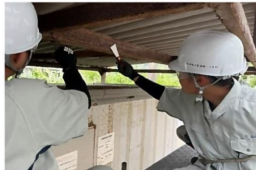
錆落とし状況
