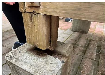
脚部腐敗状況
